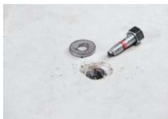
Разрушение по стали анкера
