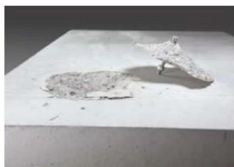
Разрушение от выкалывания бетона основания
