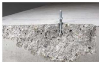
Разрушение от откалывания края основания
